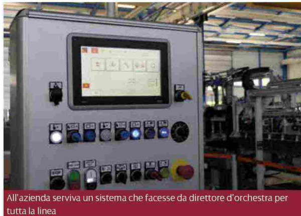
Le comunicazioni fra PC supervisore e PLC sono gestite via rete Ethernet e protocollo Profinet
