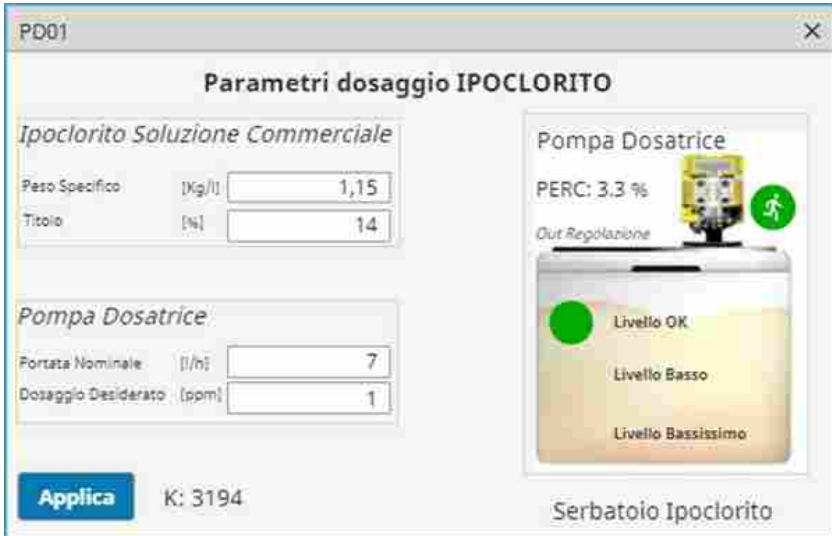
Schermata di controllo dei parametri di dosaggio di ipoclorito di sodio nell'acqua potabile.
